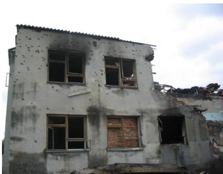
Школа, разрушенная в ходе теракта.
